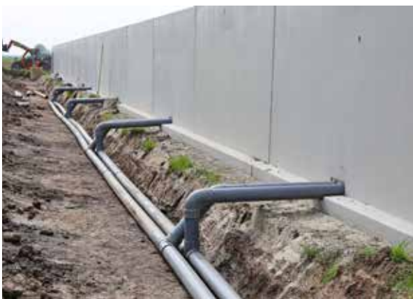
Figuur 3 Een duo-afvoer in een nieuwe kuilopslag.
